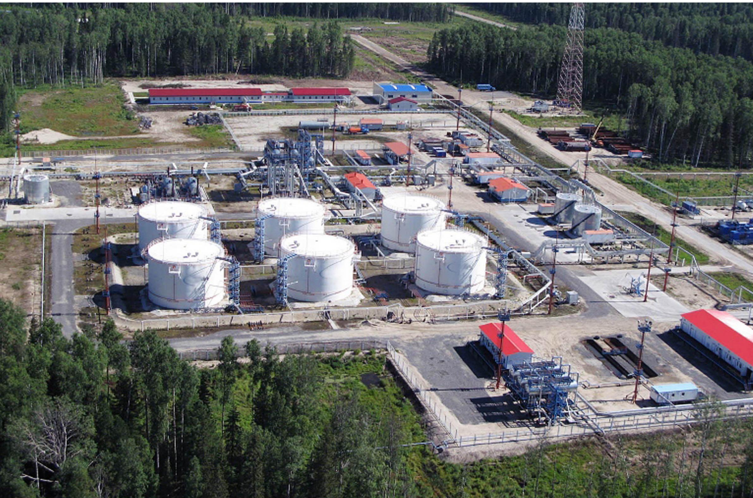
Установка подготовки нефти (нефтесборный пункт) "Уфа" уфимского филиала ОАО "Конвент"
